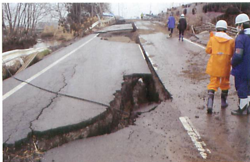
写真1 道路の亀裂(県道石巻工業港矢本線)
