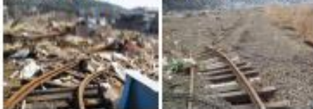
E【線路流失】 (大船渡線 細清橋内) F【線路流失】 (大船渡線 陸前失作～竹駒)
